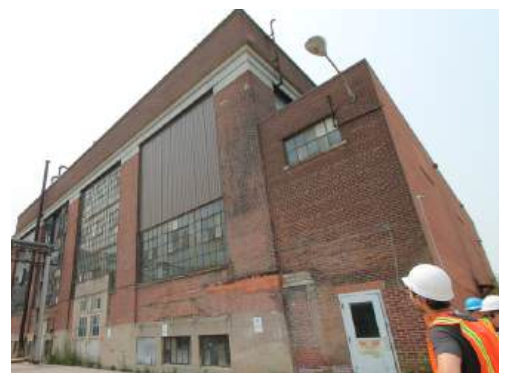
26. Infilled windows (ERA, 2023)
