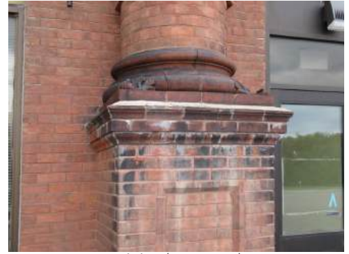
27. Masonry staining (ERA, 2023)
