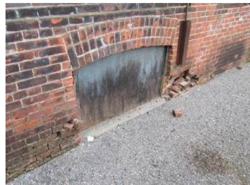
23. Brick deterioration (ERA, 2023)
