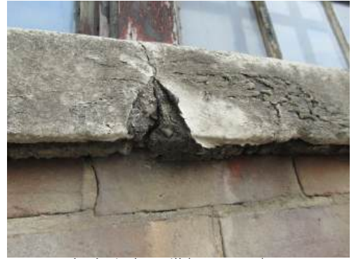
30. Cracked window sill (ERA, 2023)
