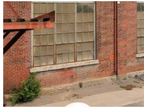
22. Deteriorating concrete base (ERA, 2023)
